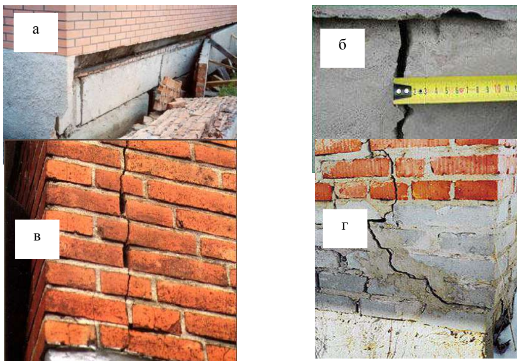
Рис. 3. Характерные типы разрушения фундаментов, наступающие вследствие просадок грунта основания.
