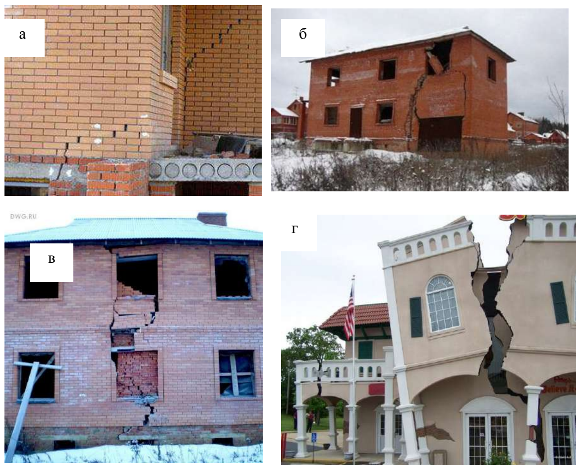
Рис. 4. Характеры разрушения стенок возведенных зданий из-за разрушения фундамента.
