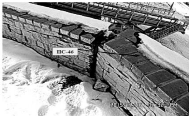
Рис. 1. Дефектная конструкция подпорной стенки
