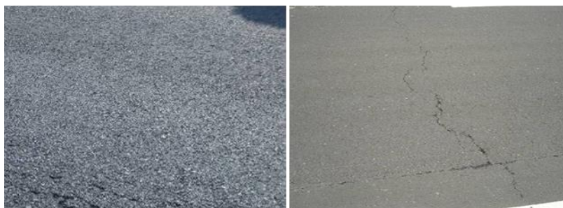
а) частичное выкрашивание поверхности покрытия б) трещины
